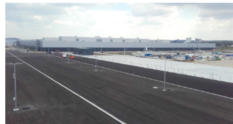
Záverečná fáza prác na jednom z parkovísk pri závode Jaguar Land Rover na okraji Nitra, vrátane aplikácie asfaltovej zálievky a inštalácie verejného osvetlenia.
