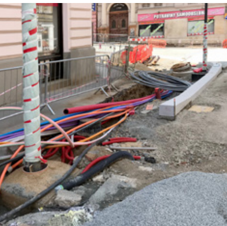
Detail inženýrských sítí v chodníku aneb takto vypadají ve skutečnosti přeložky O 2 kabelů, o nichž byla zmínka v projektové dokumentaci. Teprve později se ukázalo, že O 2 zastřešuje všechny sítě v dané lokalitě, takže počet kabelů vyšel zhruba na pětadvacet.
