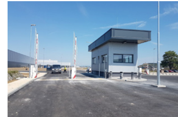
Inštalácia bariér a brán súvisí s bezpečnosťou celého areálu.
